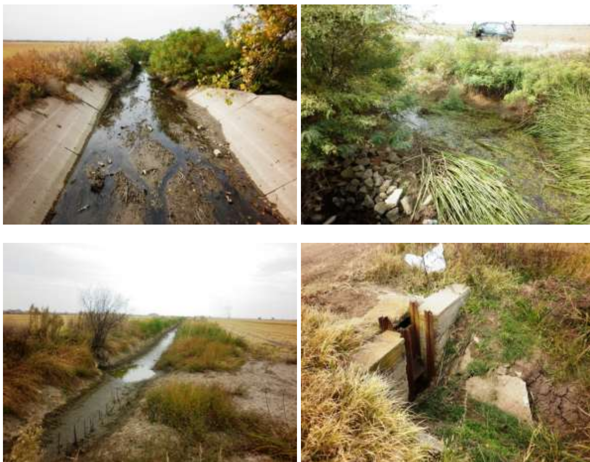
Фото 2.1.3.4.2-1. Напоителни и отводнителни канали в Защитената зона.
